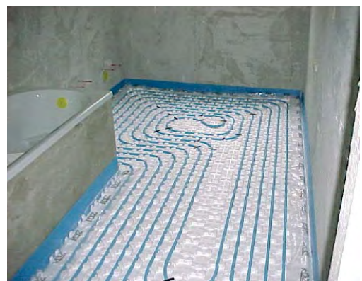
Emissione attraverso pannelli radianti a pavimento
